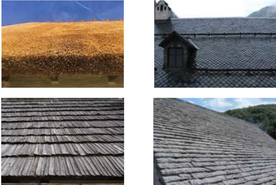
Slike 6–9: Poseganje v historično kritino in strešno konstrukcijo lahko povzroča nepovratne izgube varovanih sestavin (foto T. Hohnc)
